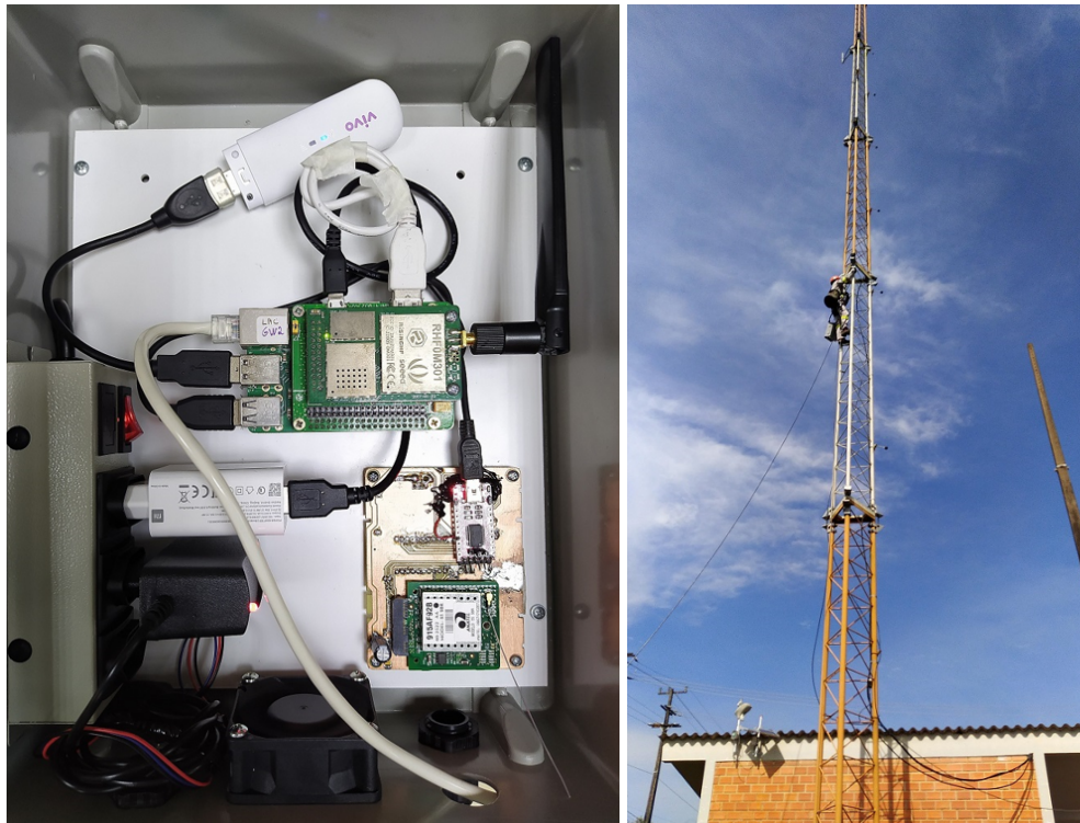
Figura A.11: Montagem do gateway LoRaWAN e local da instalação em campo.
